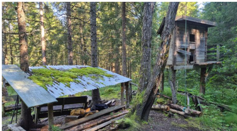
Figur 7 Tiltak langs Gamle Kongeveg av eldre dato og dårlig forfatning
